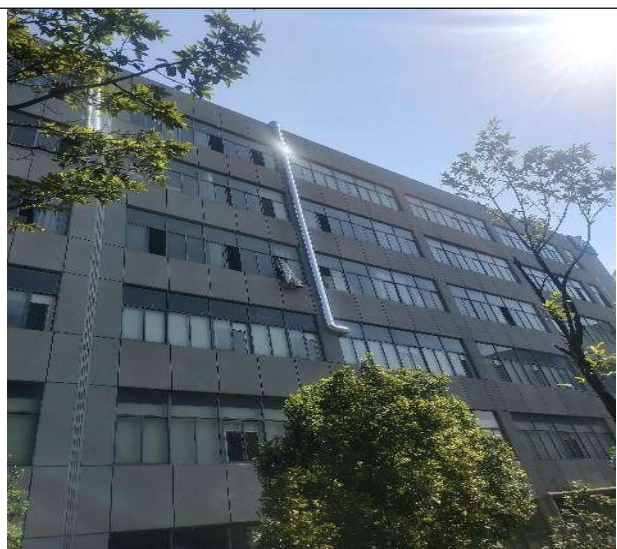
项目已设置排气筒
