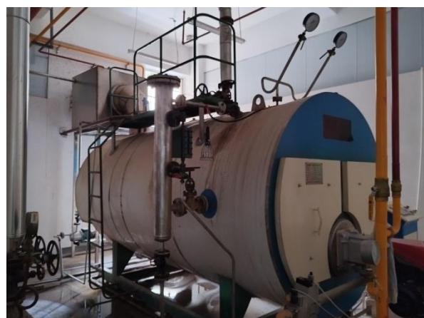
项目依托锅炉现状
