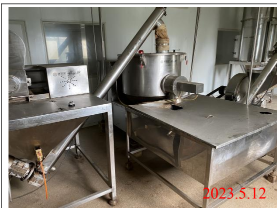
香辛料粉碎、搅拌（3楼）
