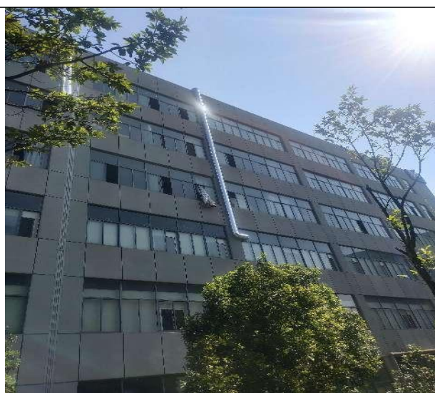
项目已设置排气筒
