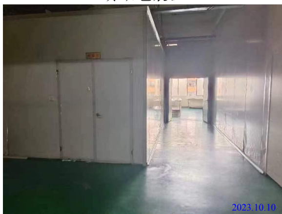
车间内部情况
