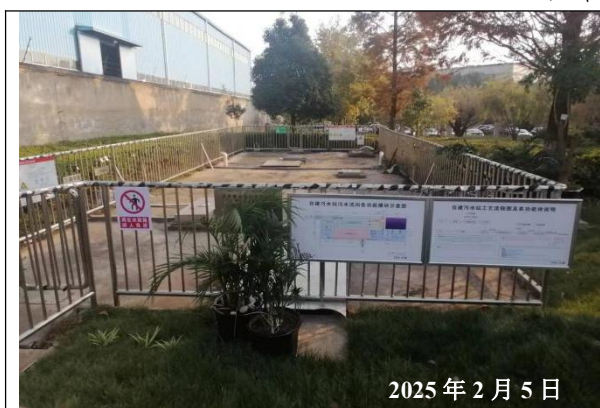
已建污水处理站
