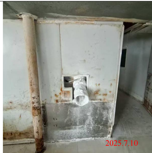
味精混合机出料口
